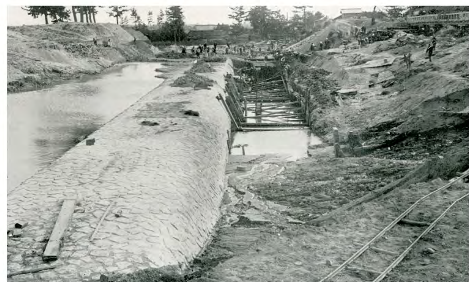
▲竣工直前の人造石による矢田川伏越 明治44年（40年以上運用され現在は鉄筋コンクリートに改築）
